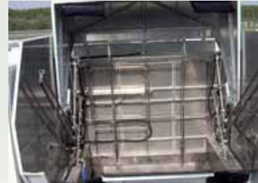
Camara de lavado exterior de contenedores.
