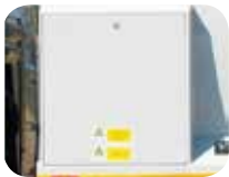
9 Cuadro eléctrico centralizado dentro de armario estanco fácilmente accesible.
