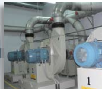
7- SALA DE VENTILADORES Y LAVADOR.
