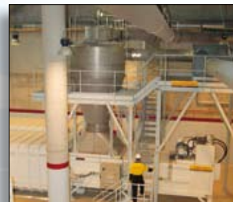
6- VISTA DEL CICLÓN Y DEL COMPACTADOR.
